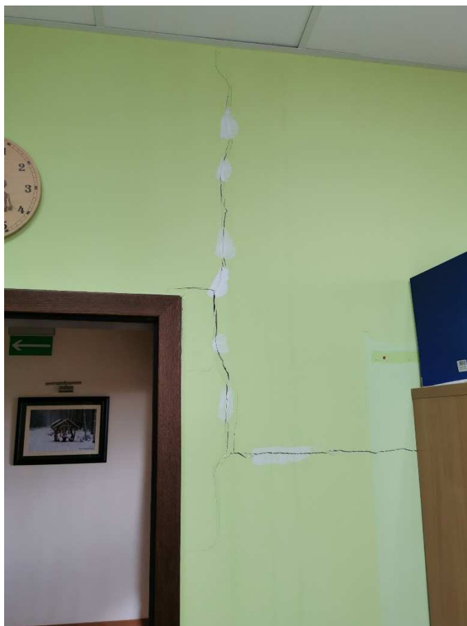
Zdj. nr 1 - Pęknięcie ścianki działowej od strony pom. 2.04
