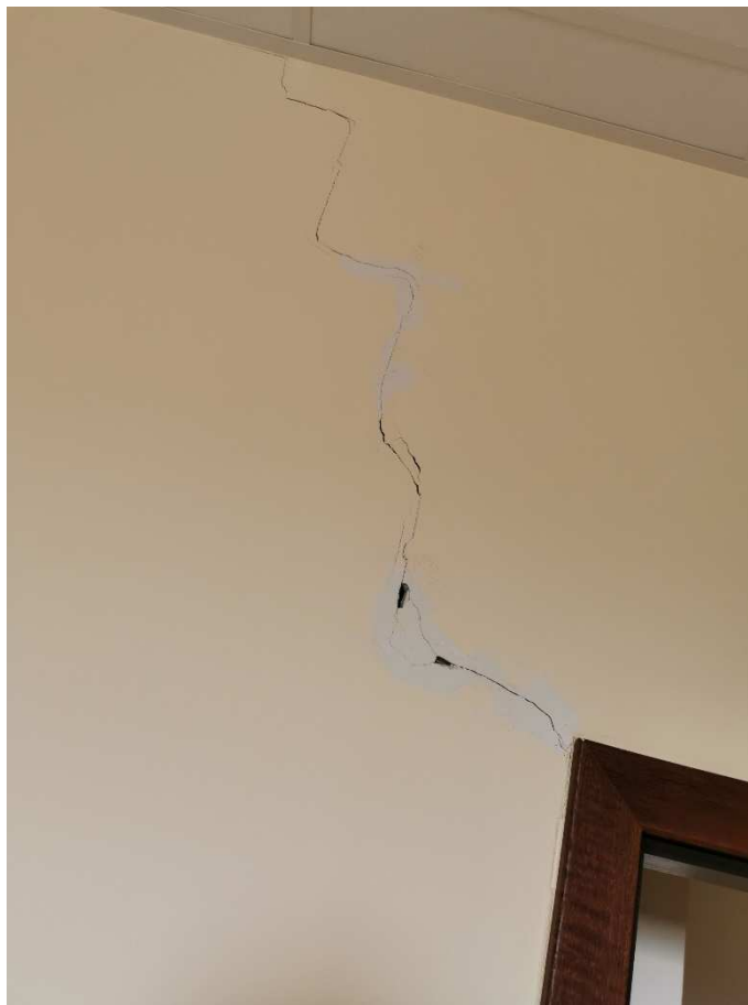
Zdj. nr 3 - Pęknięcie ścianki działowej od strony pom. 2.03
