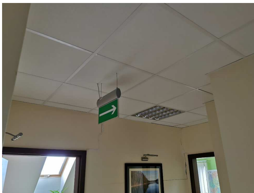
Zdj. nr 2 - Pęknięcie ścianki działowej od strony pom. 2.02
